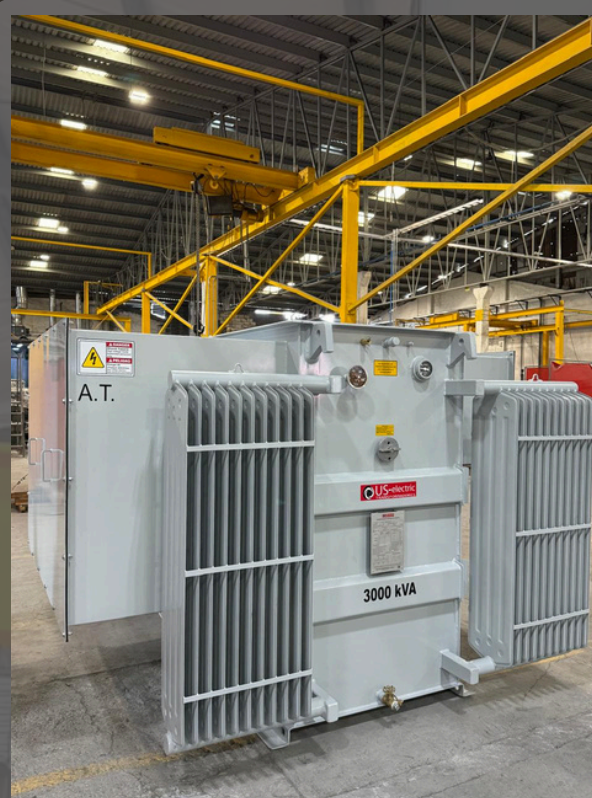
Transformador Subestación 3000 kVA
